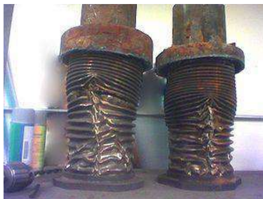
Gambar 10. Kerusakan akibat water hammer
